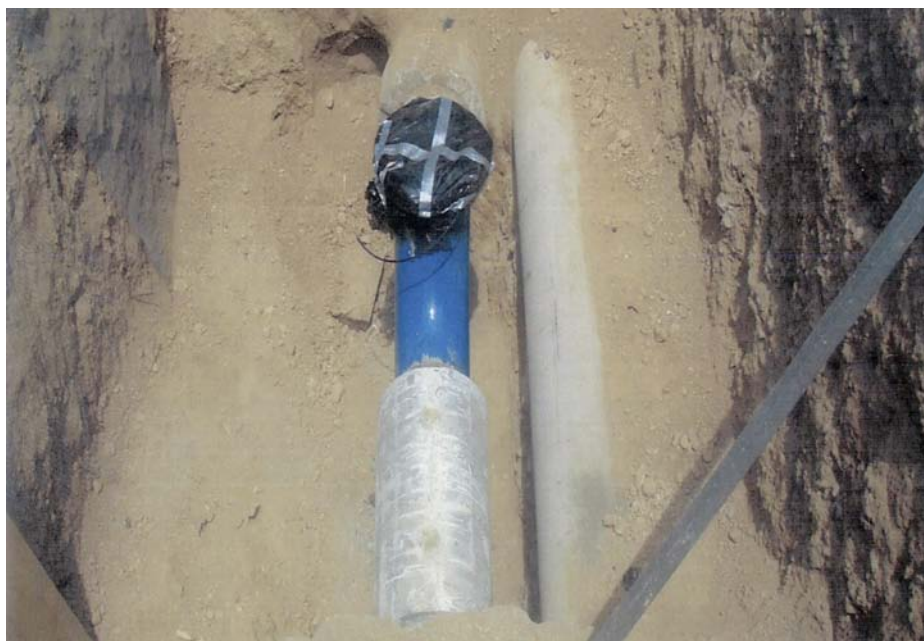
Figura 6. Sello de las líneas de tubería Bonna de 300 mm del sistema EF.
