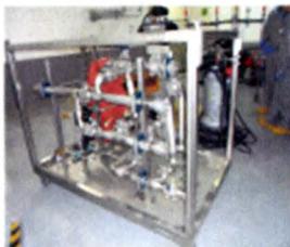
Equipo de Distribución de Lodos
