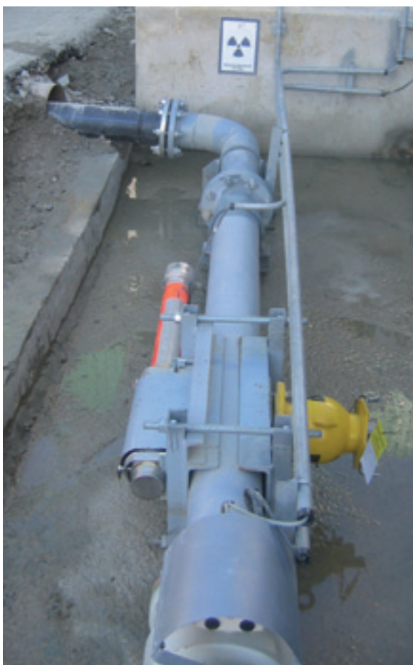
Control de procesos de medidas de densidad de fluidos que circulan por tuberías.
