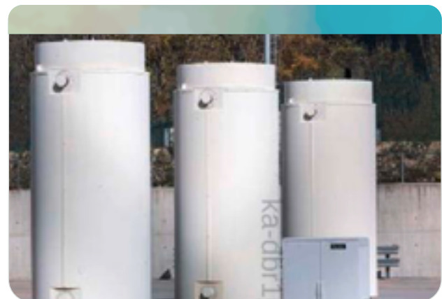
Figura 2. Contenedores de combustible
