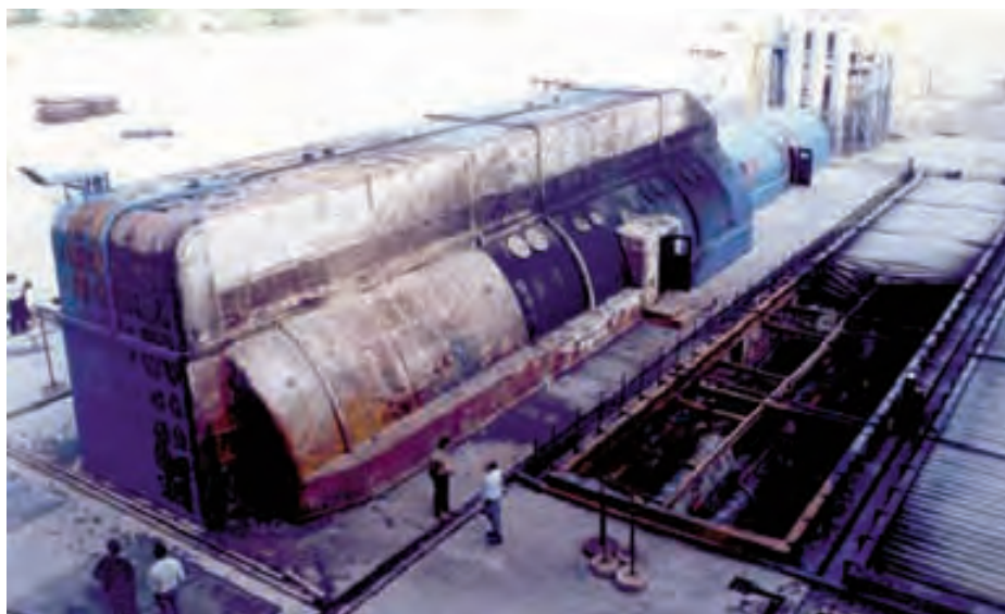
Vista parcial de la central nuclear Vandellós I tras el incendio de octubre de 1989.
