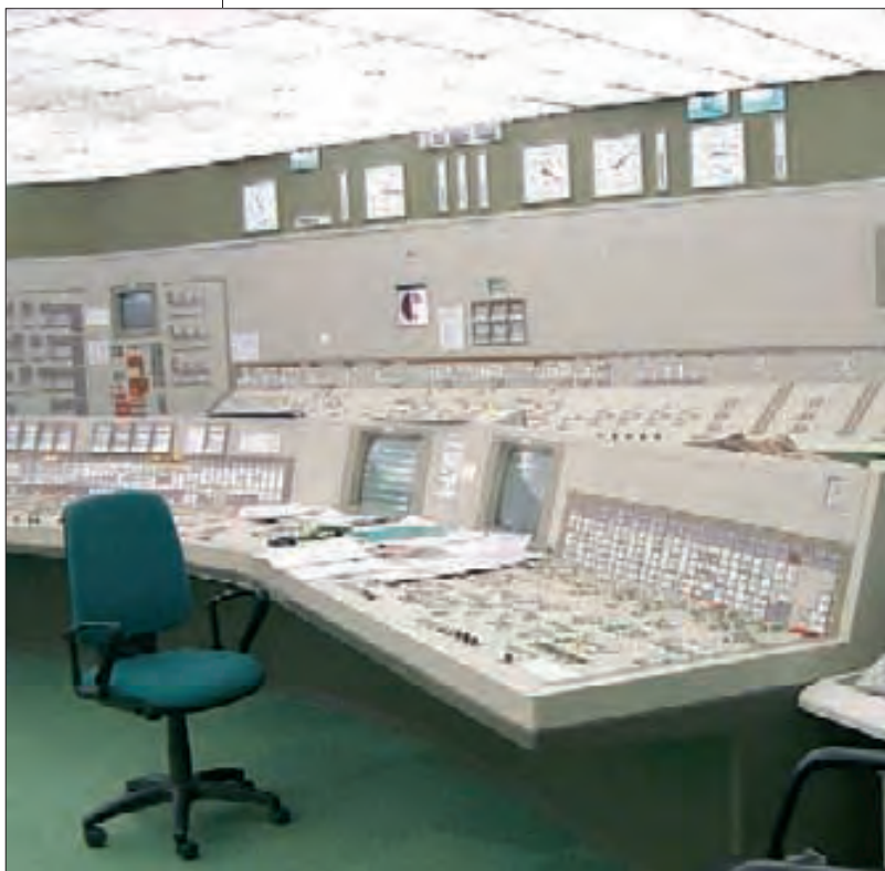
Sala de control de una central nuclear.
