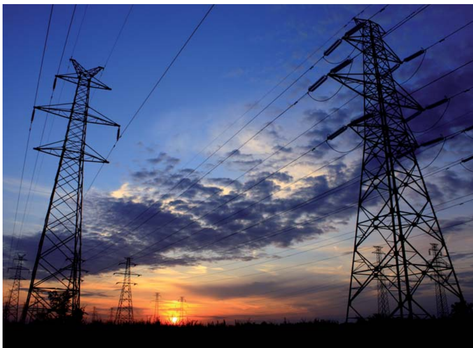
La red de transporte representa sólo el 4% del coste del sistema eléctrico.
