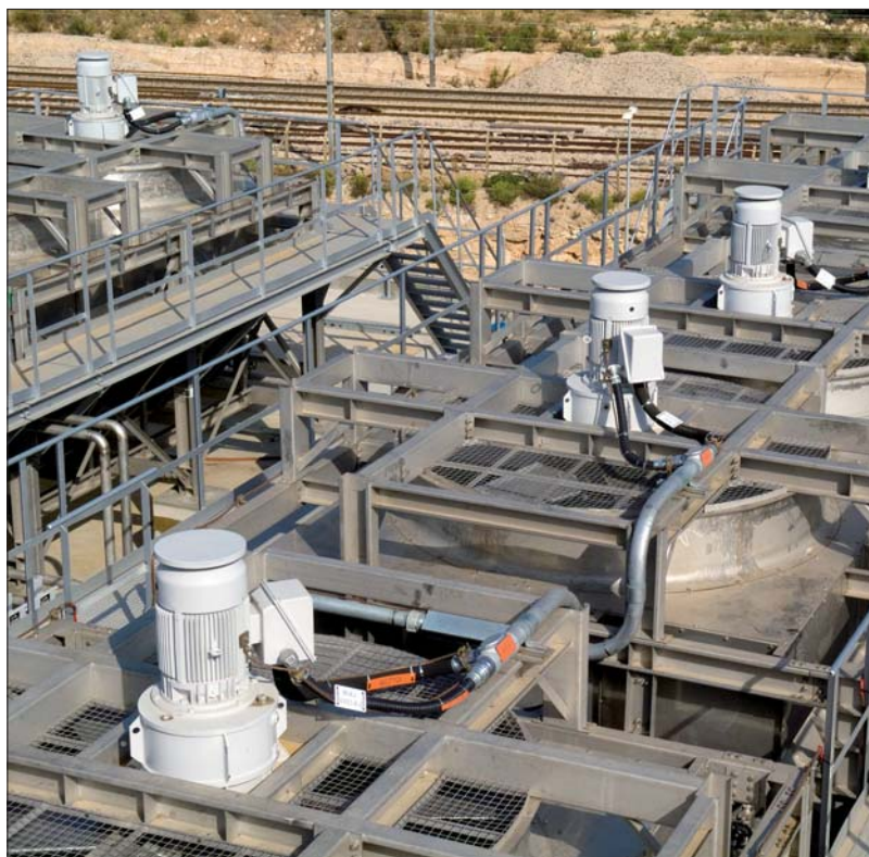
Aerorefrigeradores de la central nuclear Vandellós II.
