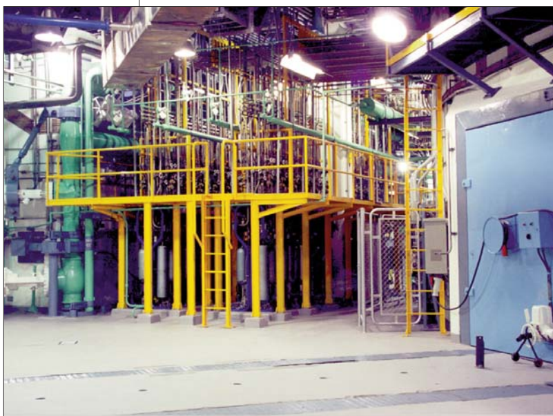
Sistemas de salvaguardias. Edificio auxiliar de Santa María de Garoña.
