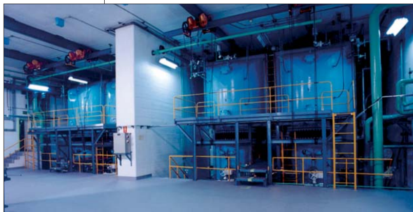
Cajas de agua del condensador principal de la central nuclear de Santa María de Garoña.
