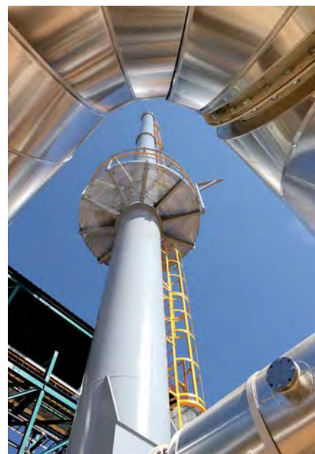
Chimenea de la instalación de Ciuden.
