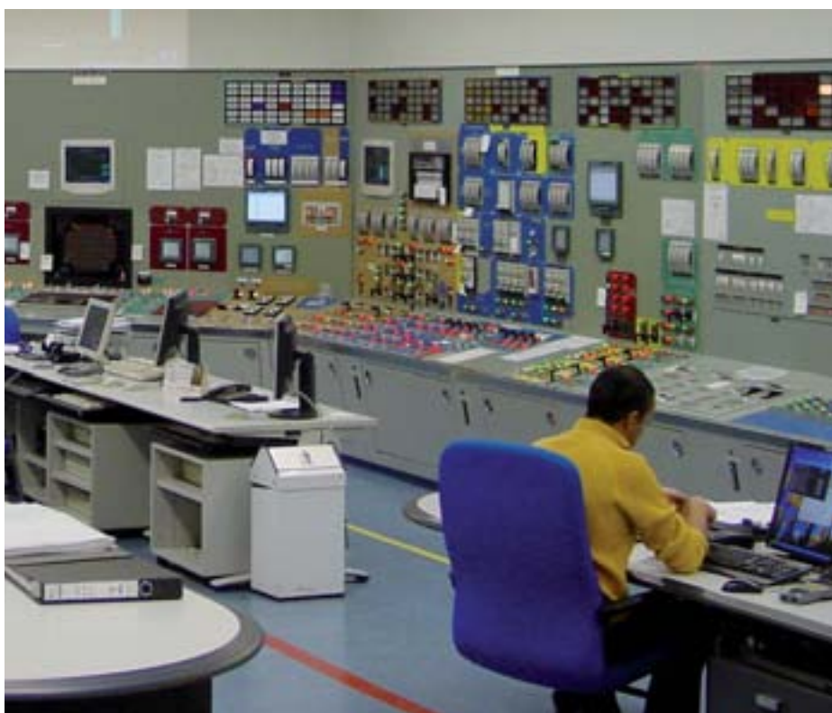
Sala de Control de una central nuclear.
