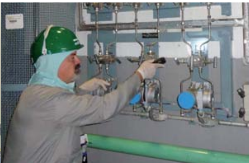
Supervisión del estado de la instrumentación local.
