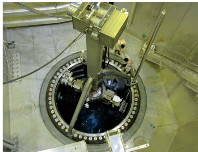
Equipo mecanizado de inspección de vasija.
