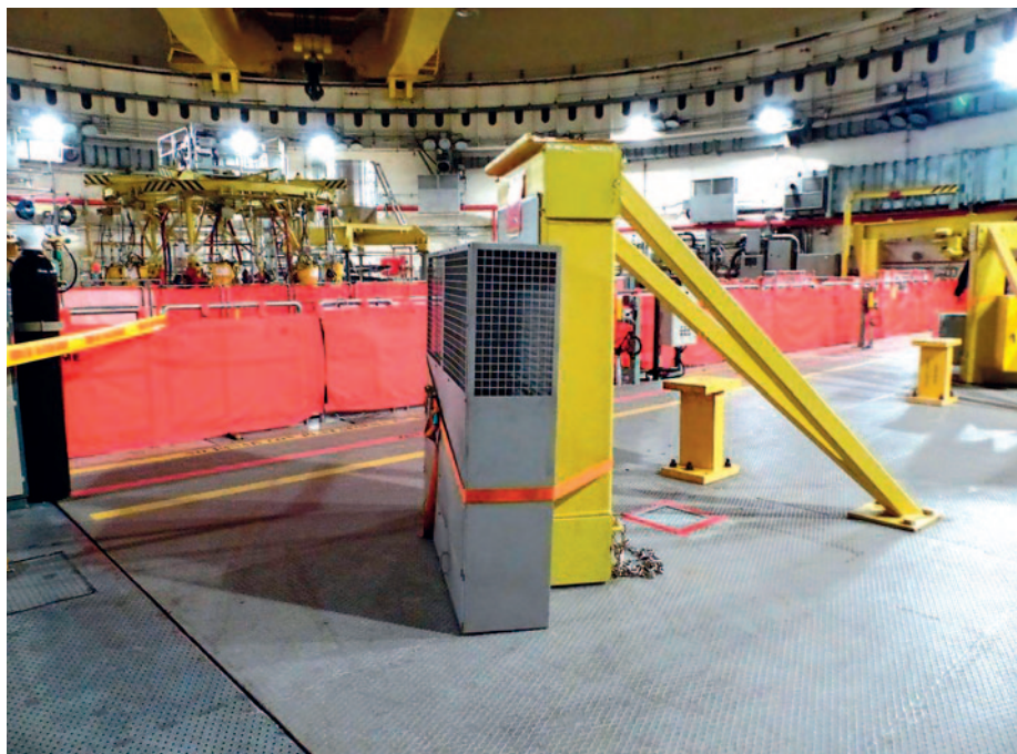
Instalación en una central nuclear de recombinaidores autocatalíticos pasivos (PAR).
