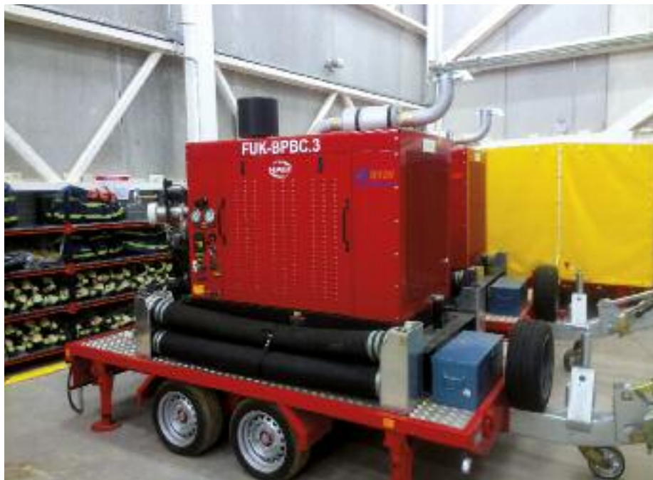
Estos equipos están sometidos a un programa específico de vigilancia y prueba periódica.
