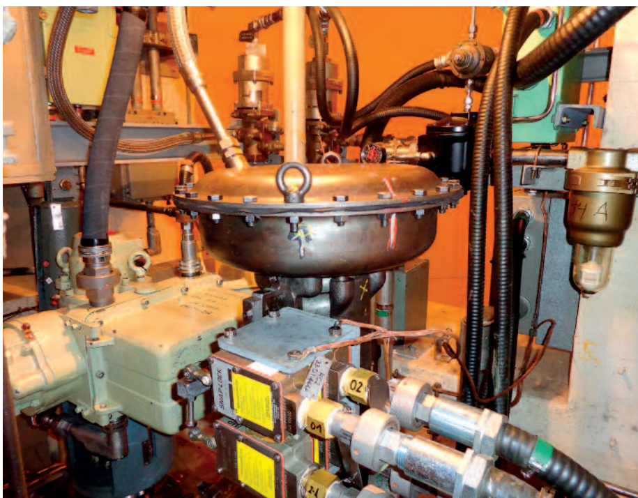
Accionador neumático de la válvula de alivio del presionador. Central PWR de tecnología Westinghouse. (Fuente: CN Almaraz).
