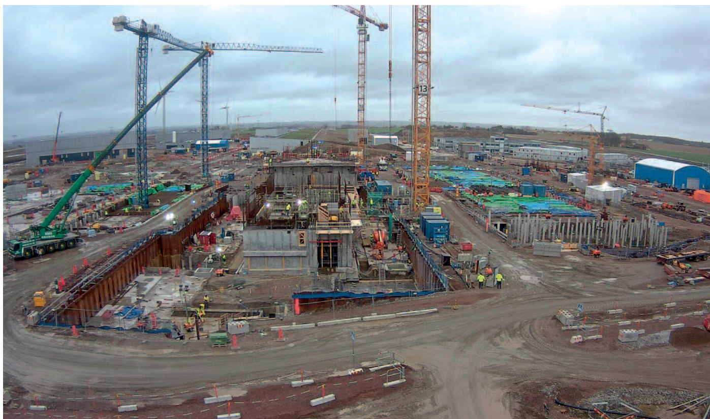
Vista aérea del pasado mes de julio del estado de las obras de construcción de la Fuente Europea de Neutrones por Espalación en Lund (Suecia). / ESS
