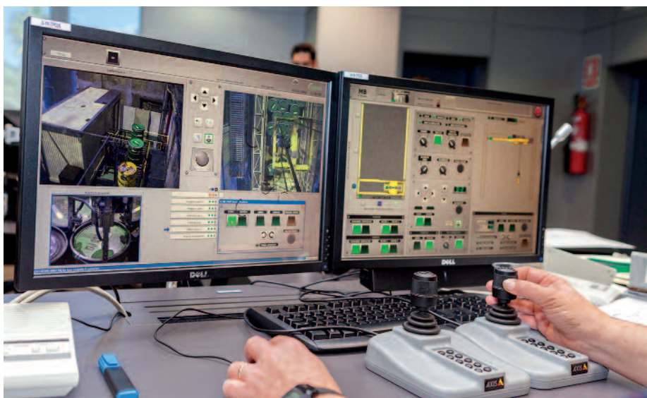
Sala de control de la instalación.
