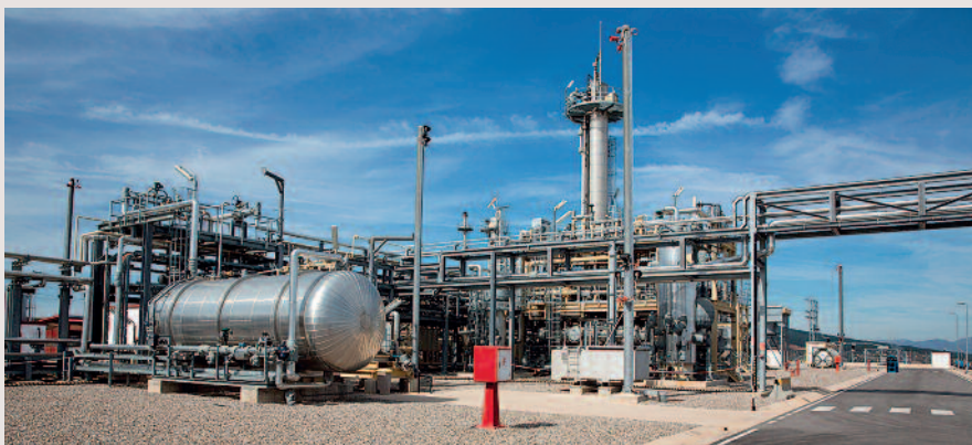
En la imagen, las instalaciones del yacimiento de gas de Viura (La Rioja).
