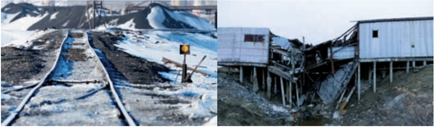
Efectos del derretimiento del permafrost en infraestructuras y viviendas de la tundra en Rusia.
