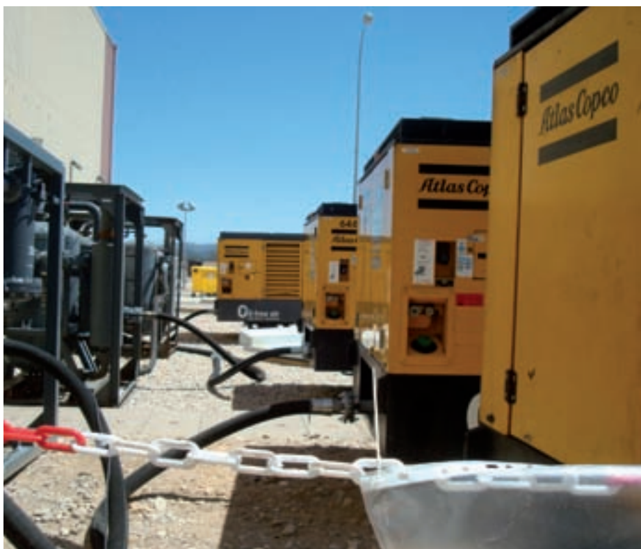
Compresores y secadores de aire empleados en la presurización del RC en una prueba ILRT.
