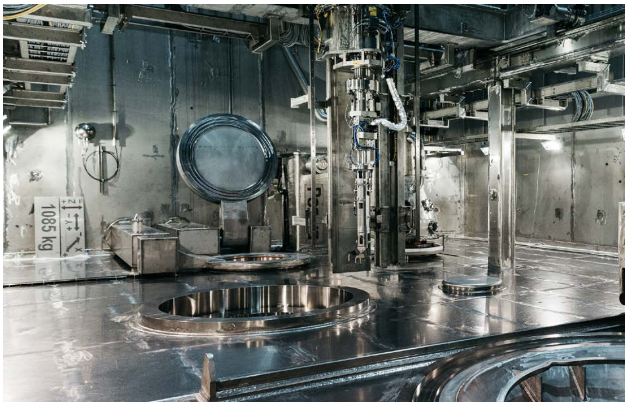
La prueba operativa de Posiva en Onkalo –su instalación de disposición final de combustible nuclear gastado– se lleva a cabo mediante control remoto integral desde instalaciones blindadas contra la radiación / Posiva.
