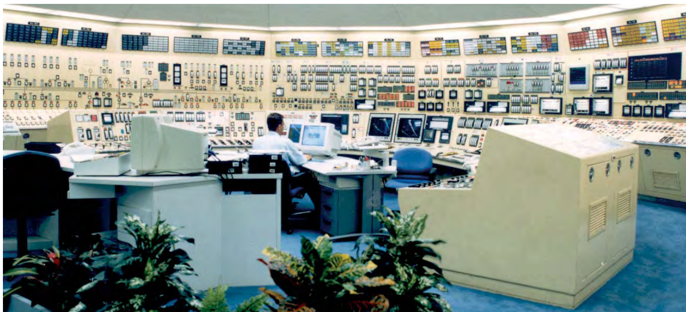
Sala de control de Vandellós II. Muchos de los parámetros de seguridad de la instalación que se manejan desde aquí se reciben también en el CSN.
