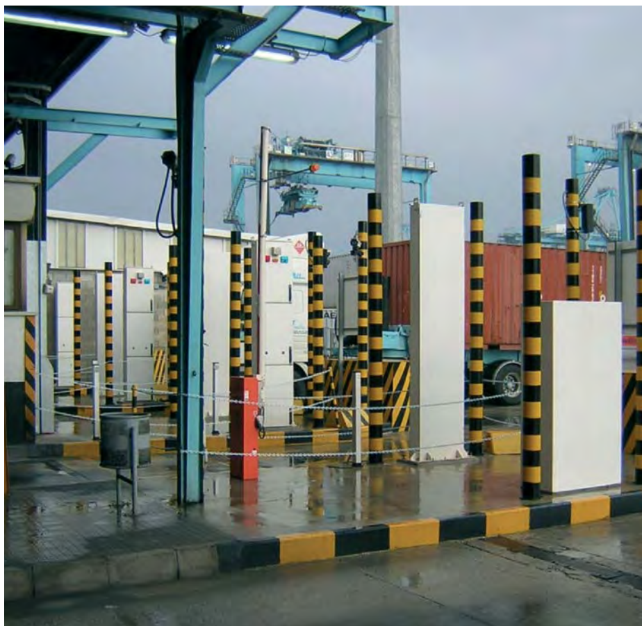
Pórticos instalados en las líneas de importación del Puerto de Algeciras.
