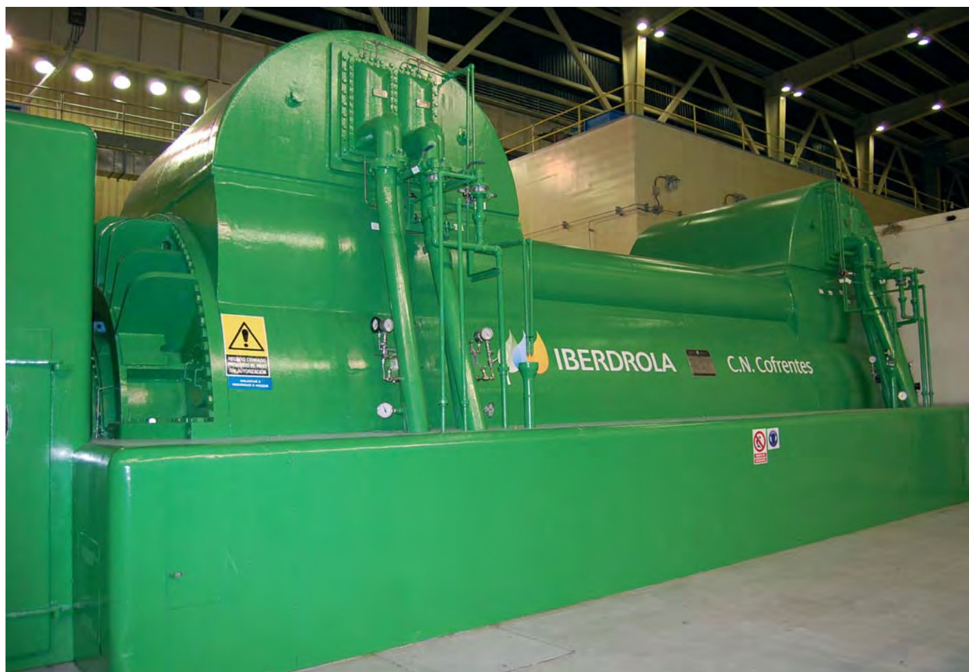
Generador de la central nuclear de Cofrentes.
