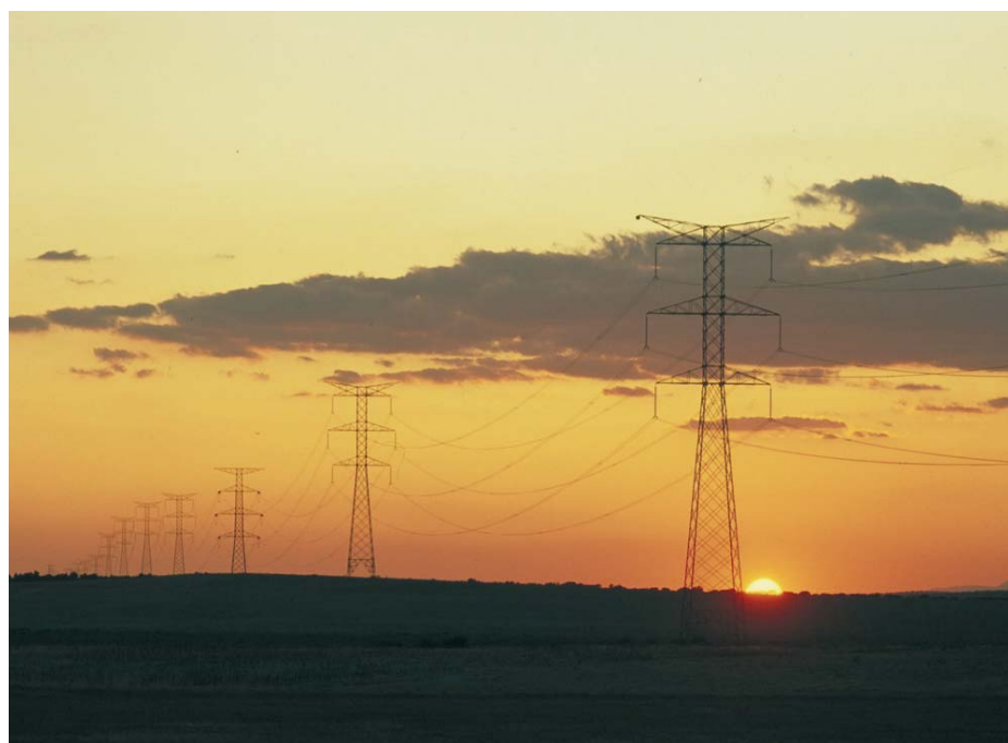
Las líneas de alta tensión generan campos de radiación electromagnética no ionizante.
