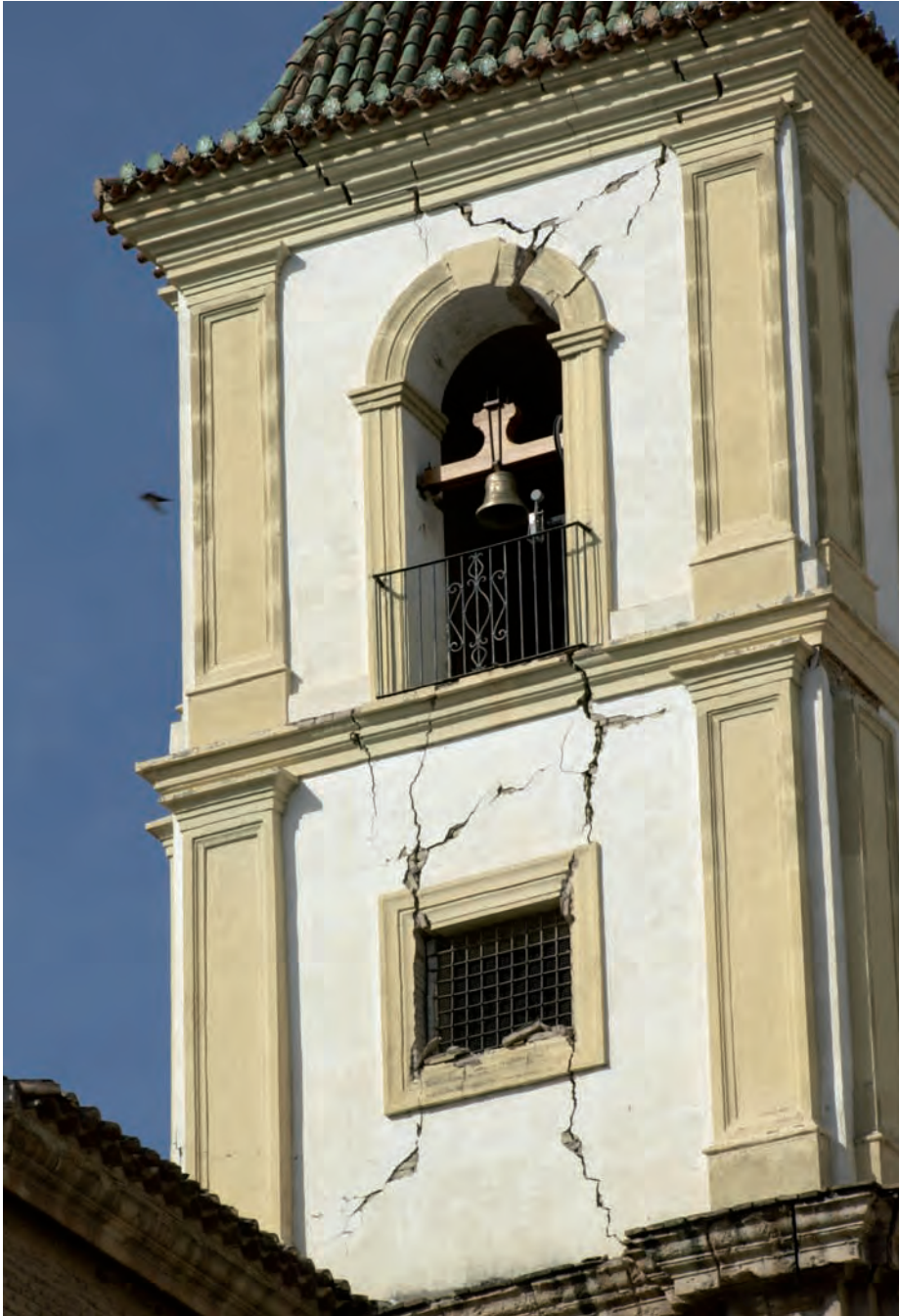
Torre de la iglesia de Santiago Apóstol, de Lorca, tras el terremoto.
