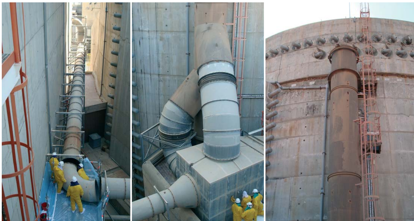
Distintas partes del conducto de ventilación. A la izquierda, operarios realizando su limpieza; en el centro, el plenum de la ventilación; a la derecha, la chimenea de descarga.
