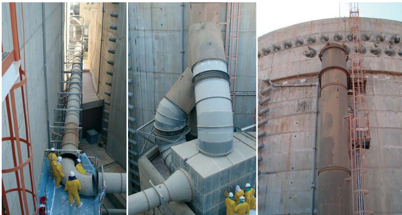
Distintas partes del conducto de ventilación. A la izquierda, operarios realizando su limpieza; en el centro, el plenum de la ventilación; a la derecha, la chimenea de descarga.
