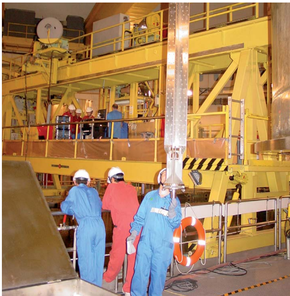
Inspección de una barra de control en la central nuclear de Cofrentes.
