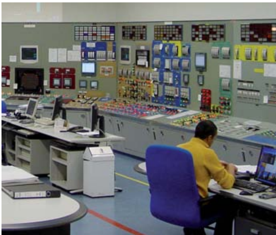
Sala de Control de una central nuclear.
