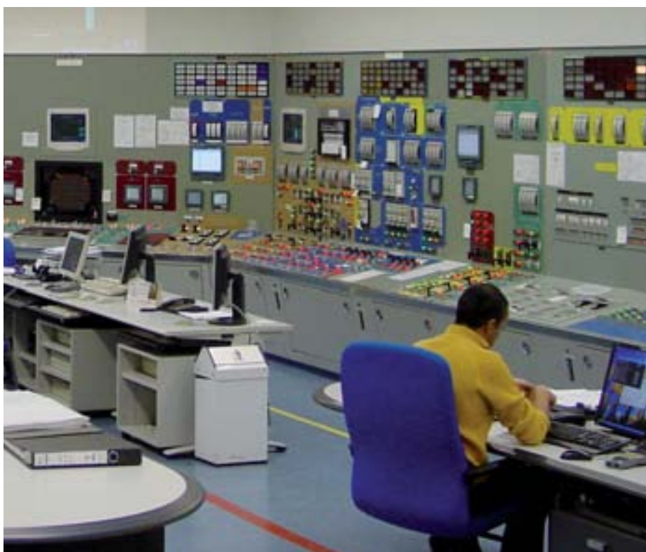
Sala de Control de una central nuclear.
