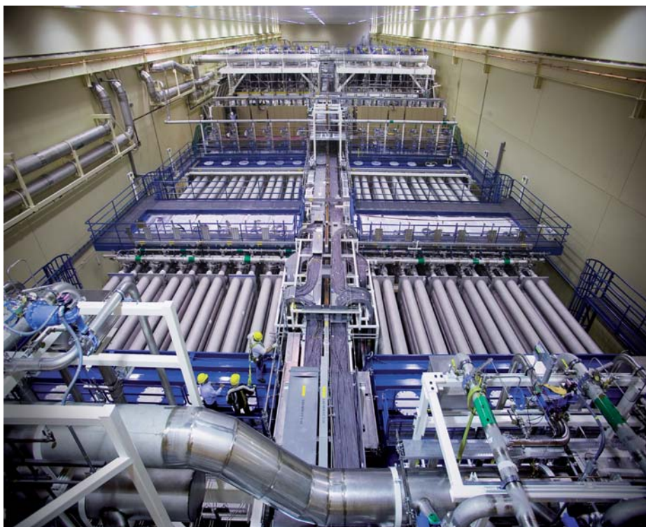
Vista general de las instalaciones de NIF con los tubos por los que discurren los rayos láser.
