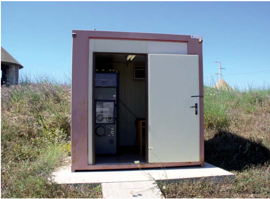
Estación de la REA en Tarifa.
