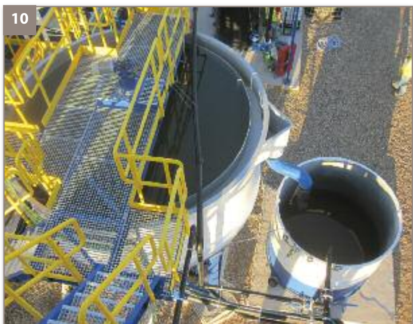
10. RECUPERACIÓN DE AGUA Y DESHIDRATACIÓN DE FINOS. El material más fino, tras un proceso de decantación, se envía a la etapa de filtración.
