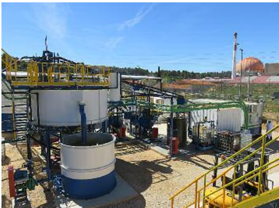
DESCONTAMINAR, SU OBJETIVO. La función de la planta de lavado de áridos es la de gestionar y tratar los suelos afectados por contaminación radiológica, utilizando técnicas de descontaminación
