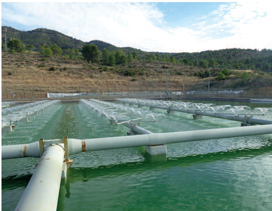
Estanque esenciales BWR con aspersión por pruebas de caudal.
