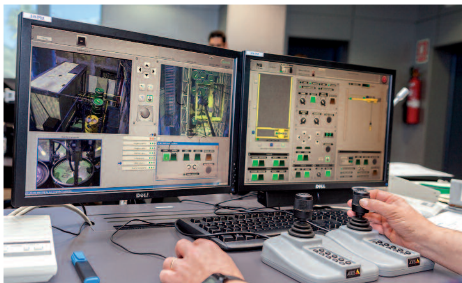
Sala de control de la instalación.
