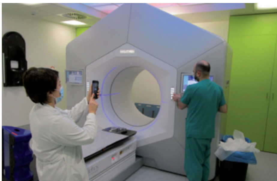
Inspección telemática del acelerador en el interior del búnker.
