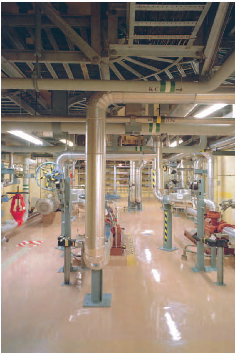
Interior de la central nuclear de Ascó.
