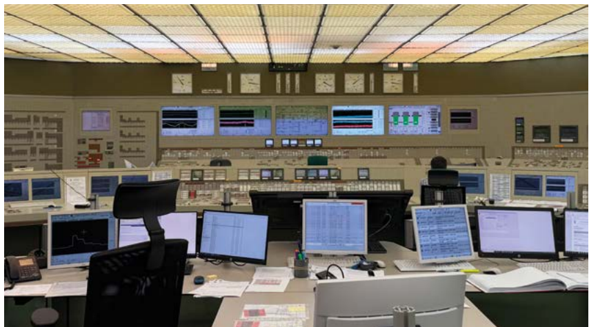
Sala de control de la central nuclear Trillo
