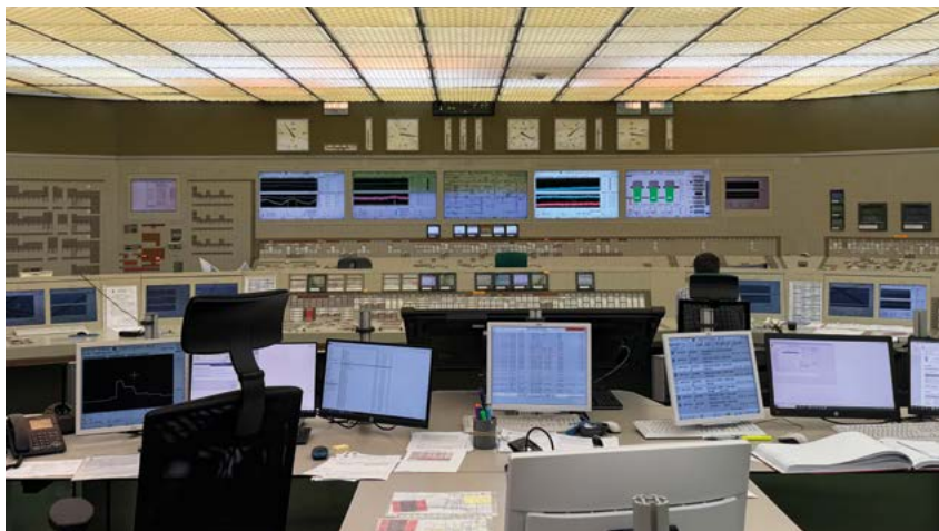
Sala de control de la central nuclear Trillo
