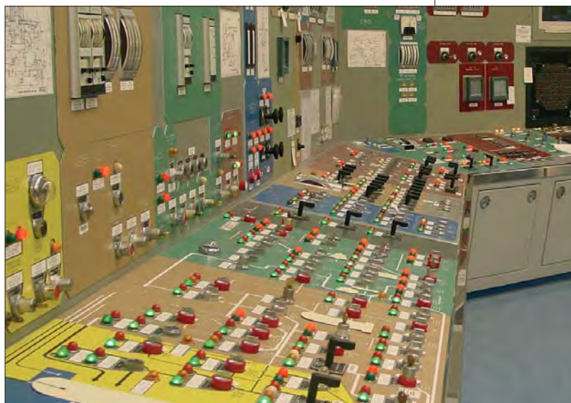
Paneles de la sala de control de Cofrentes.
