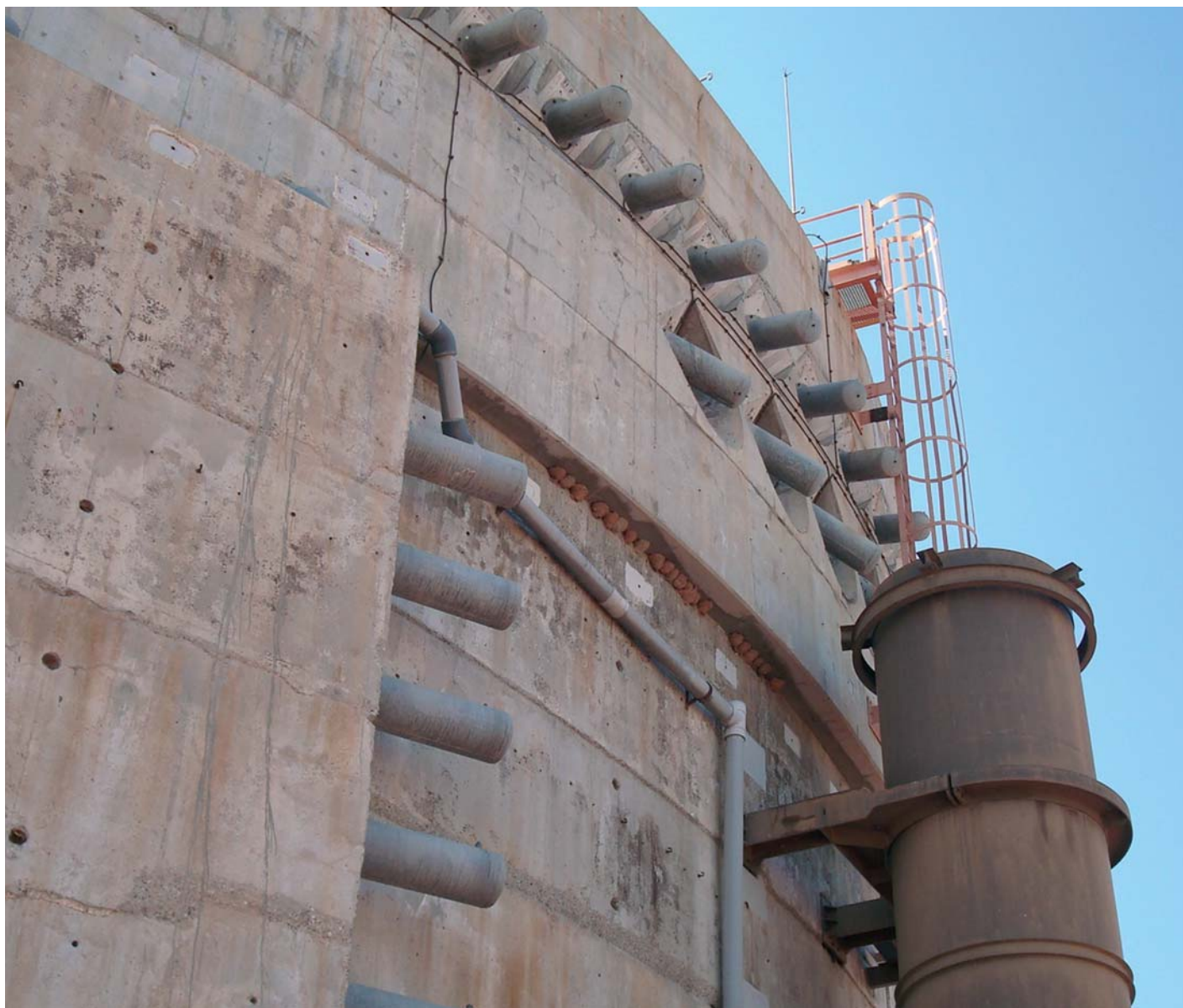
Chimenea por la que se expulsa el aire de los edificios de la zona controlada.
