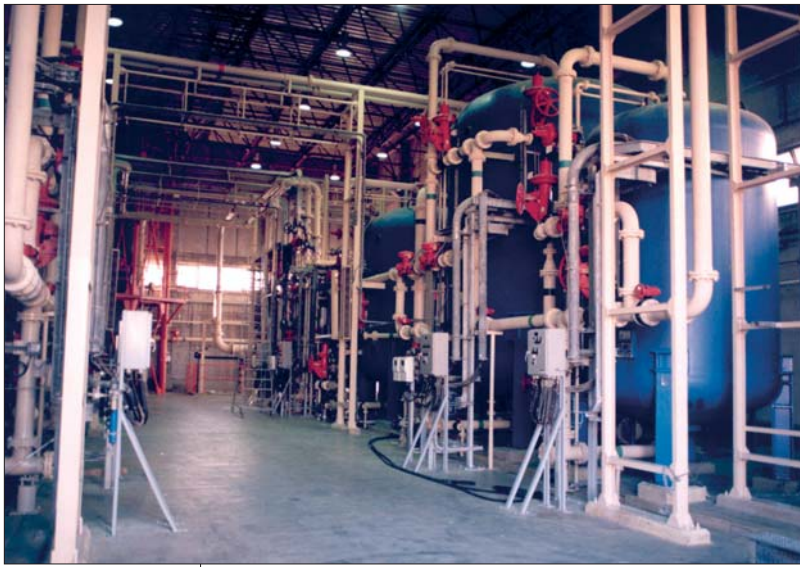
Planta de tratamiento de aguas de la central nuclear de Ascó.
