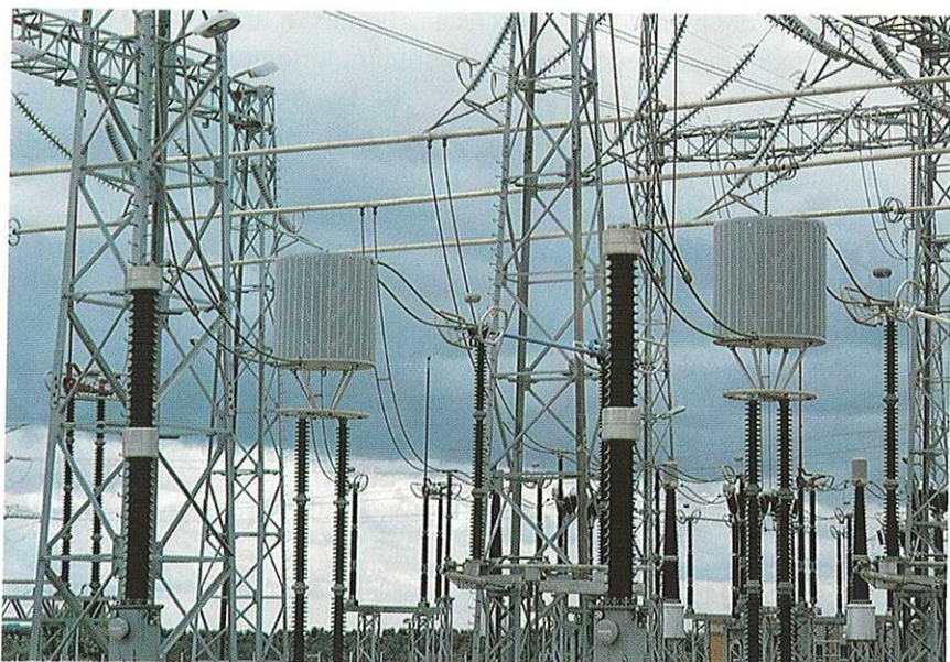
Figura 2. Subestación de 400 kV.
