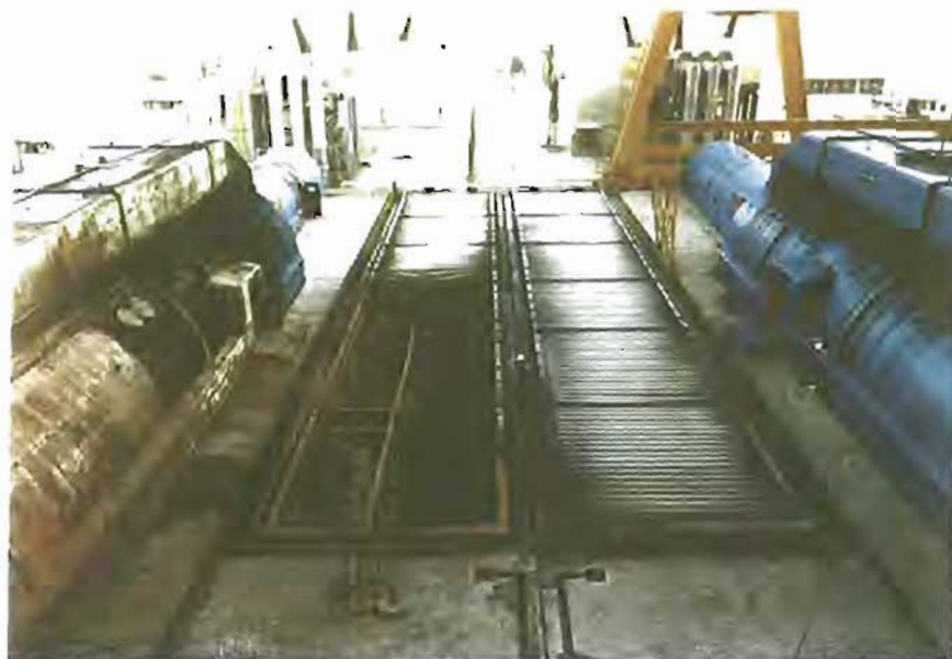
Figura 3. Estado final de las dos turbinas de la central nuclear Vandellós I, tras el fuego ocurrido en una de ellas el 19 de octubre de 1989 (foto cedida por Hifrensa).
