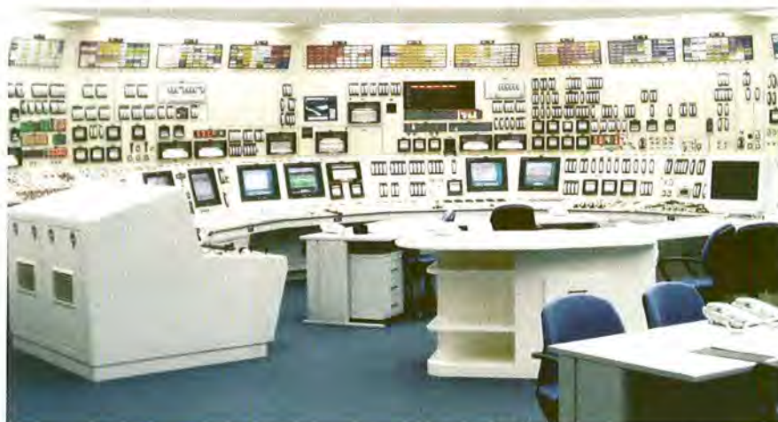
► Figura 6. Sala de control del simulador réplica de la central nuclear Vandellós II.
