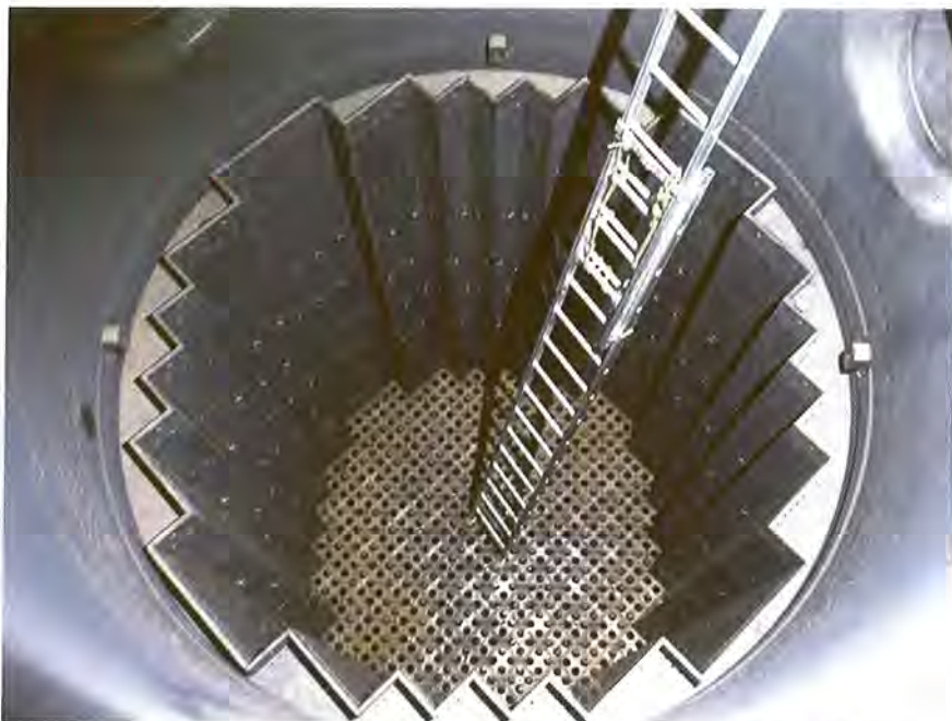
► Figura 2. Vista de la piscina del reactor vacía durante la parada de recarga.
