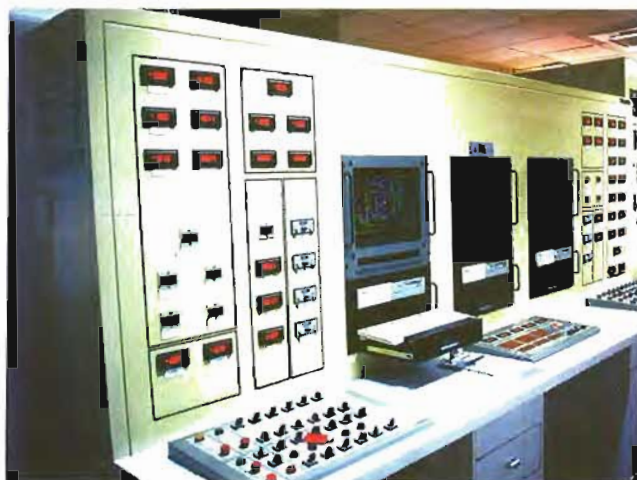
Panel de control de la planta de tratamiento de agua de la central nuclear de Ascó.
