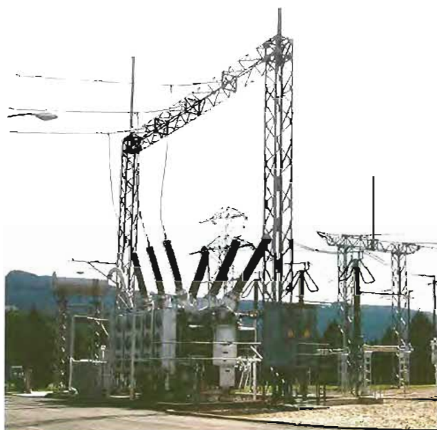
Vista del parque eléctrico de la central nuclear Santa María de Garoña.
