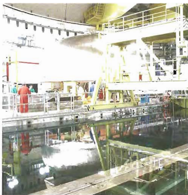
Piscina del reactor de la central nuclear de Cofrentes.
