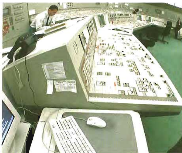
Vista parcial de la sala de control de la central nuclear de Trillo.
