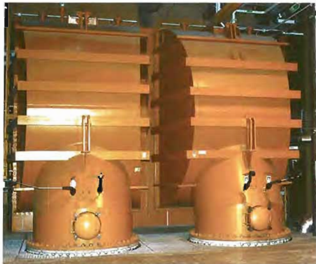
Vista interior del edificio de turbinas de la central nuclear de Trillo.
