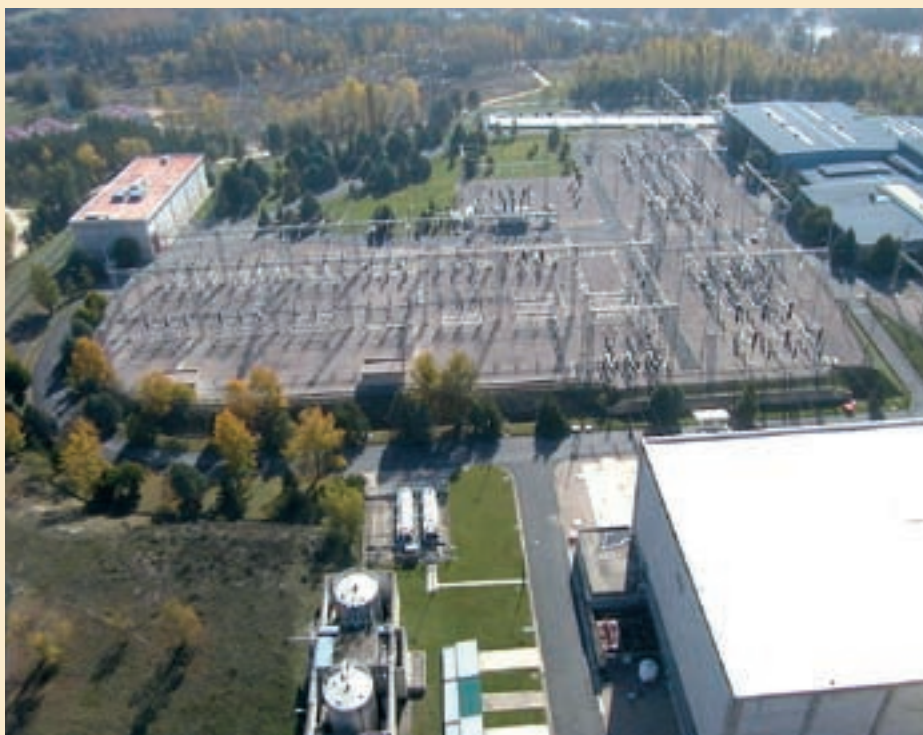
Parque eléctrico de la central nuclear Santa María de Garoña.
