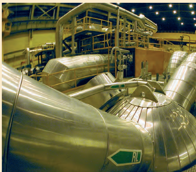
Vista parcial de la sala de turbinas de la central nuclear de Trillo.
