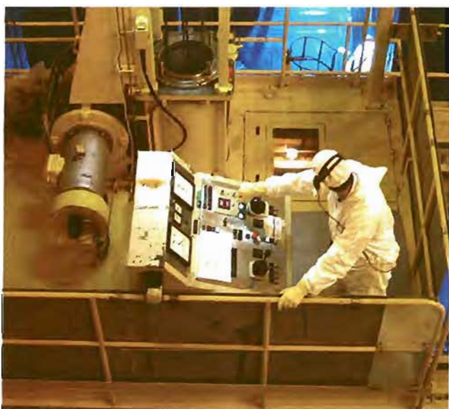
Grúa de recarga de combustible de la central nuclear de Almaraz.
