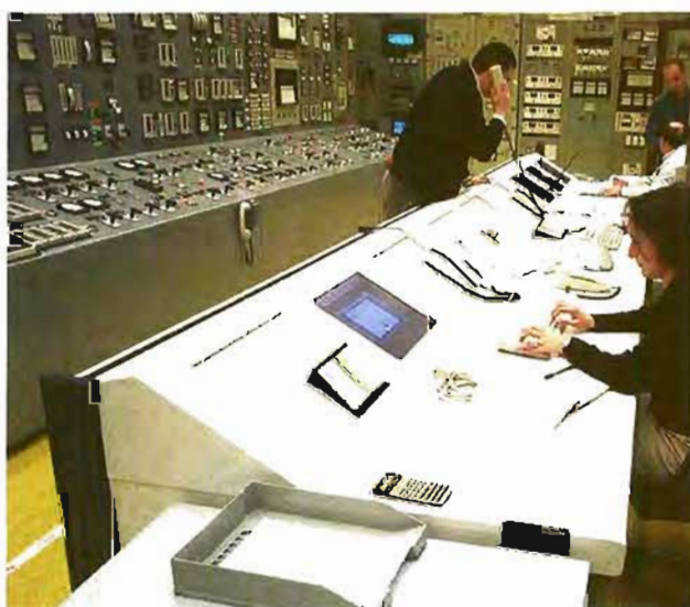
Sala de control de la central nuclear José Cabrera.
