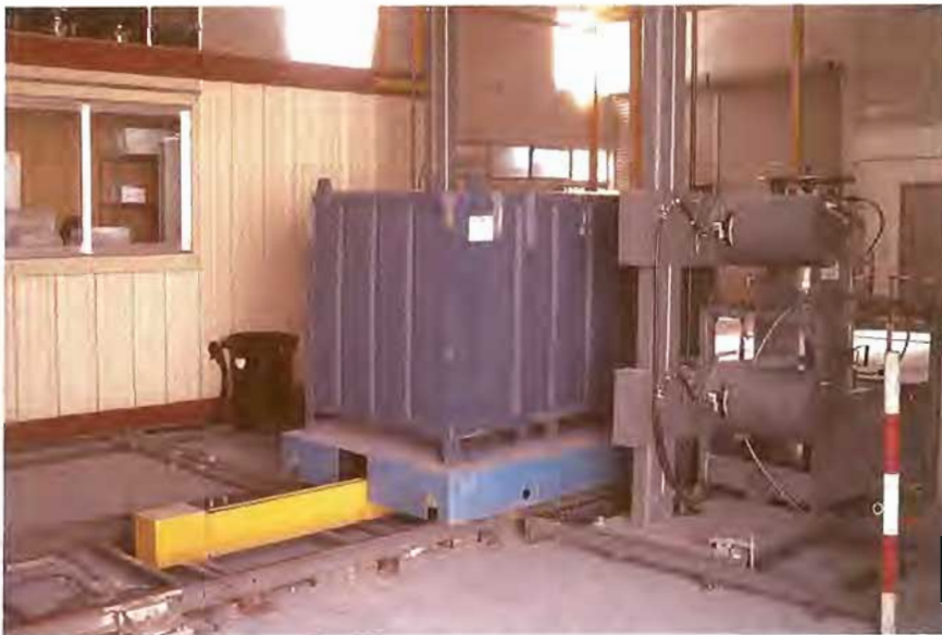
○ Figura 2. Equipos para la caracterización radiológica previa a la desclasificación.
