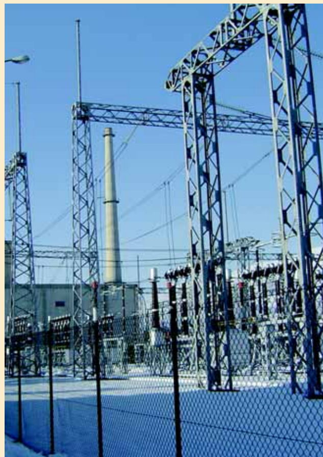
Central nuclear Santa María de Garoña. Subestación.
