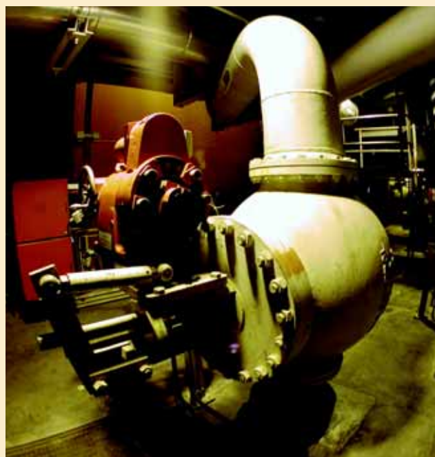
Central nuclear de Trillo. Detalle de las válvulas.
