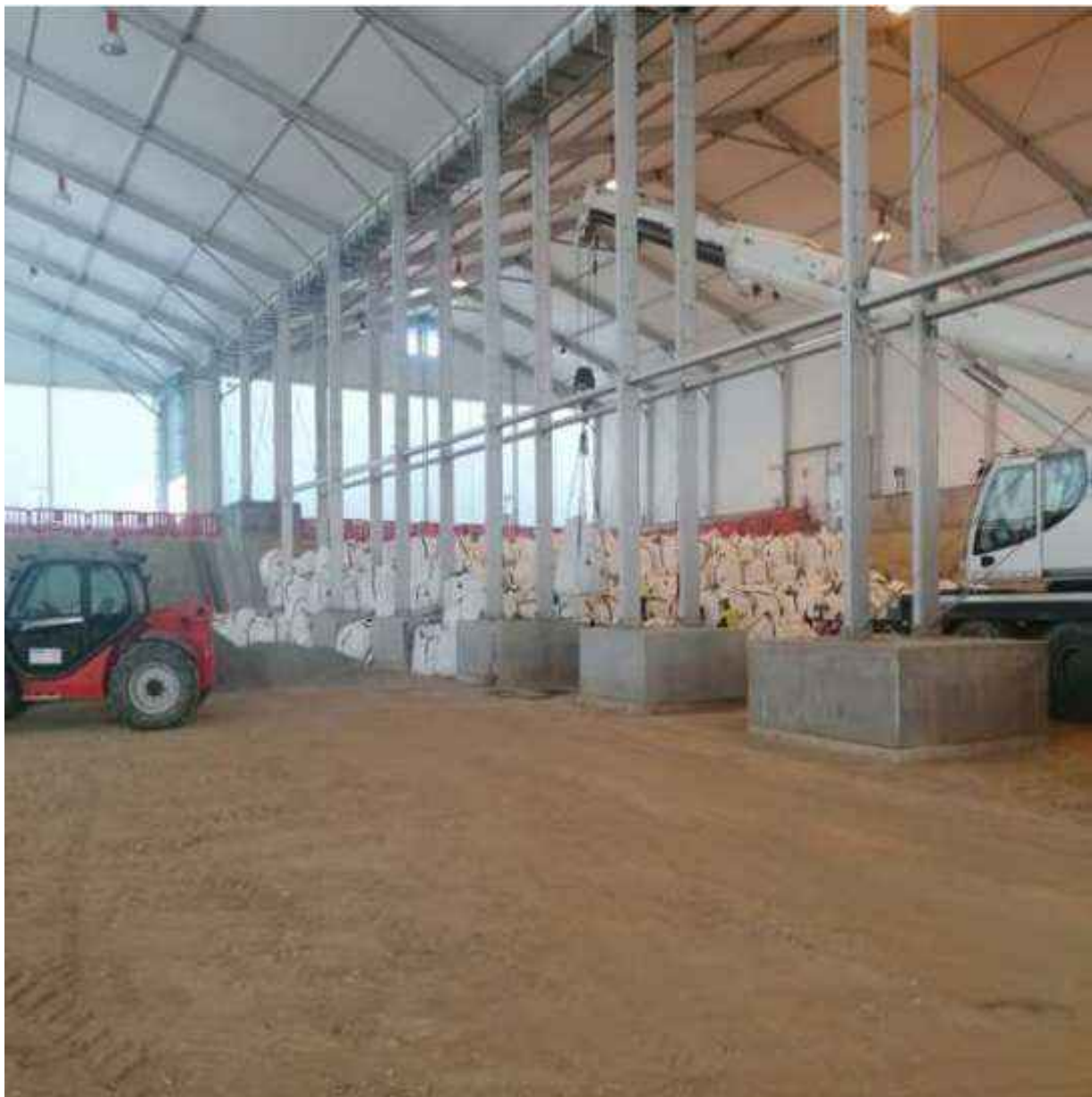
Fotografía 1: Celda 29 llenado de la celda tras la reanudación de explotación, línea 3 sección 2 bajo cubierta
