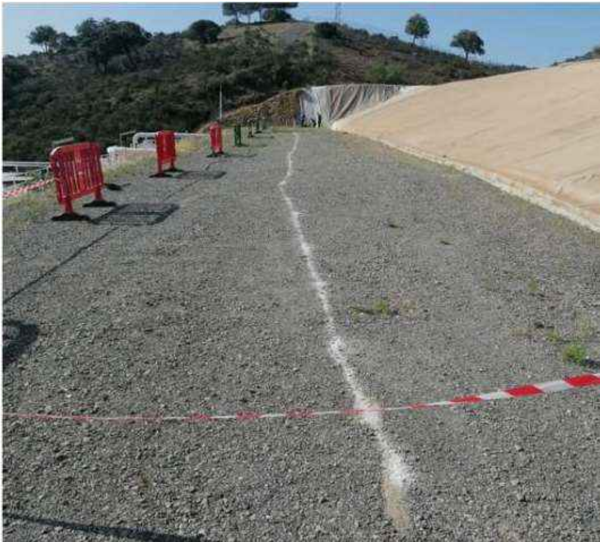
Fotografía 2: Celda 29 Al fondo; catas previas a la excavación de zanja paralela al pie de caballón en la berma del trasdós. Exterior de celda 29
